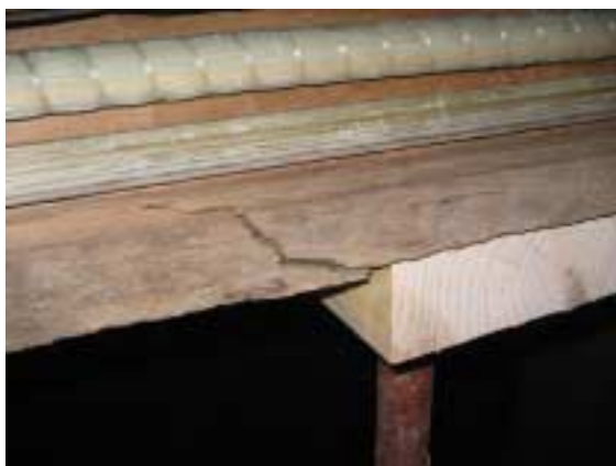
Cassure de la poutre – Saignée avec barres de fibre de verre en renfort
