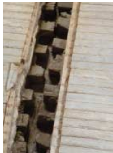
1 er étage : le trou sera comblé par un mélange de béton et fibre de verre pour soutenir par le haut la poutre
